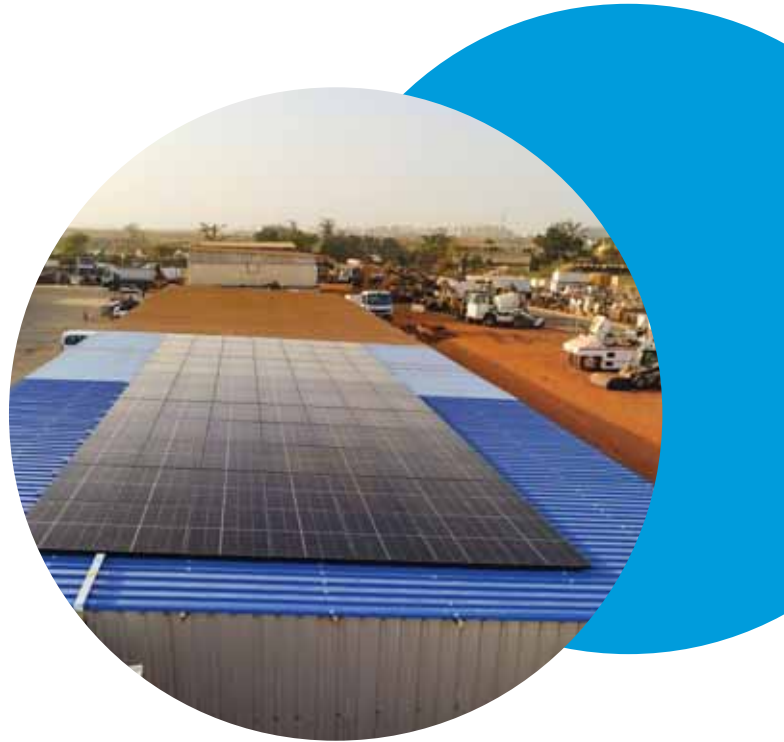
Солнечные панели, установленные в компании Eiffage Sénégal
